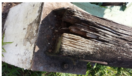
Figura 1 – Apodrecimento da base de um pilar inclinado.
