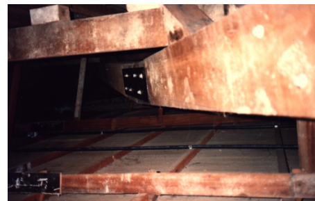
Figura 2 – Deformação excessiva de uma viga de madeira na região da emenda de duas peças.
