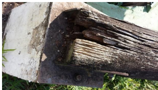
Figura 1 – Apodrecimento da base de um pilar inclinado.
